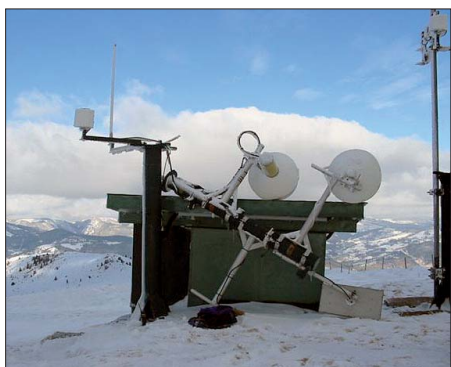
Das Bild zeigt die defekte Antennenanlage von F6KDL nach einem Sturm im Februar 2009.
